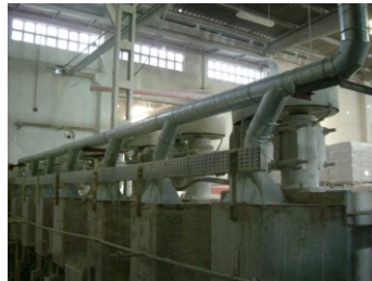
11.- Instalaciones aspiración polvo
